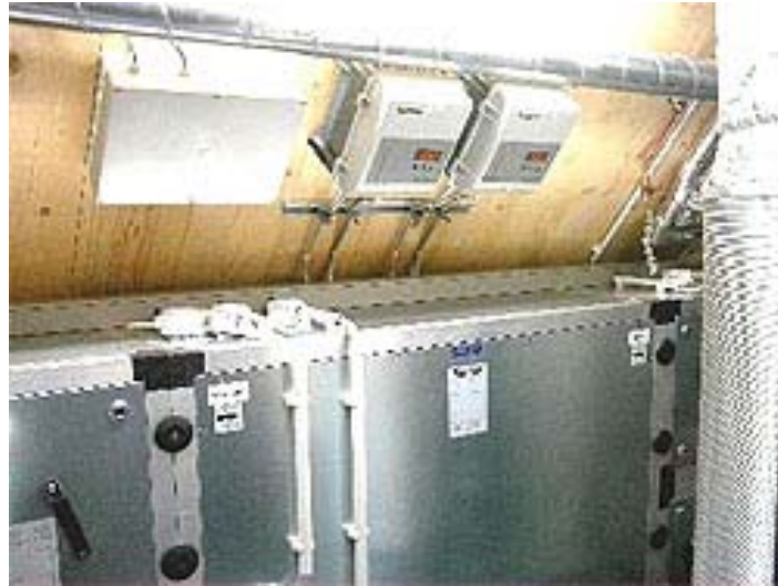
Uno dei due impianti di ventilazione nel sottotetto
