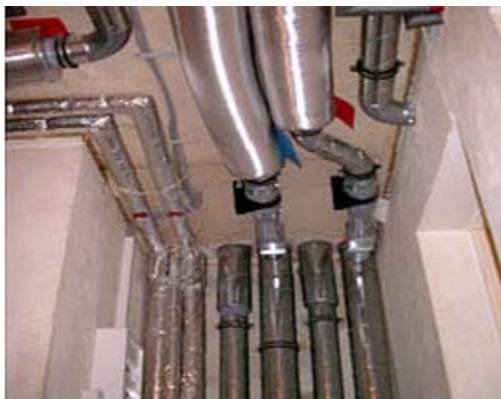
Installazioni nello scantinato dell'edificio
