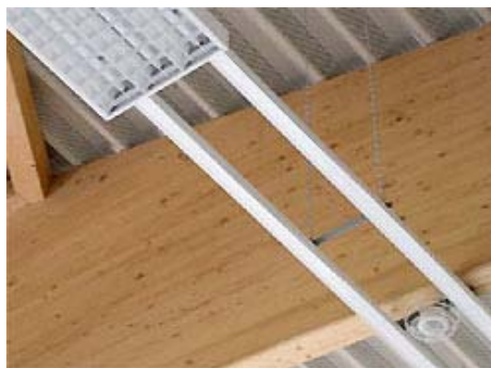
Le lampade con rilevatori di presenza
