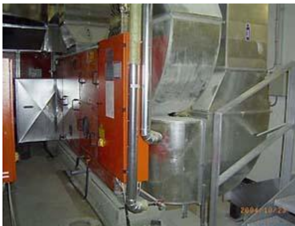
Impianto di ventilazione
