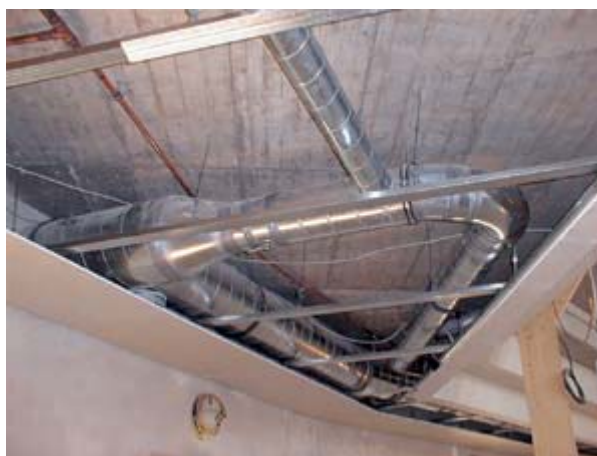
Sistema di ventilazione
