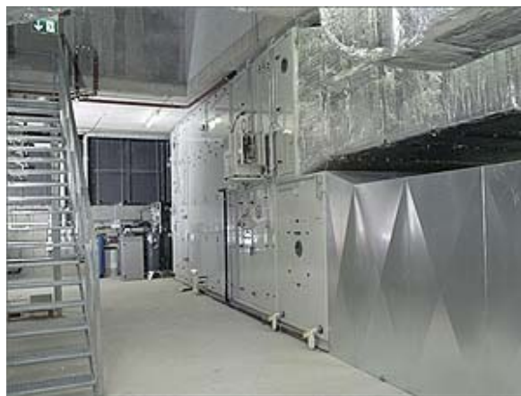
Centrale di ventilazione (Foto Conrads)
