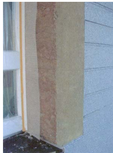
Isolamento termico presso una finestra
